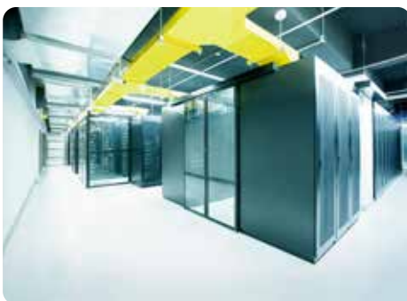
Die Kühlung in Rechenzentren erfordert energiebewusstes Handeln.
